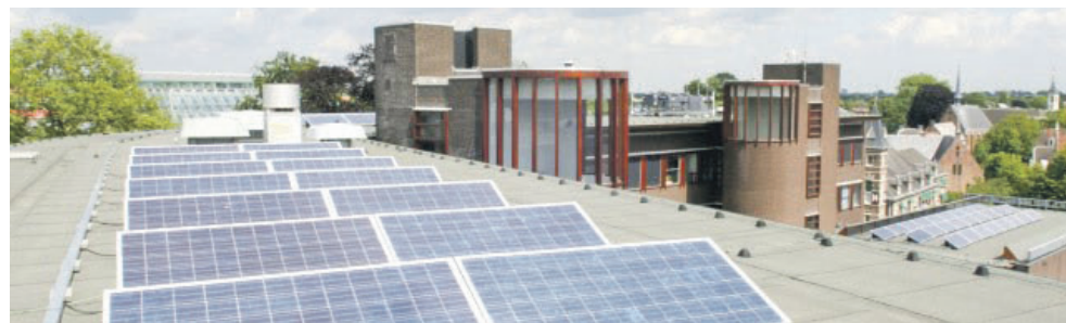
Zonnepanelen op het stadhuis (foto: Simon Lamme).
