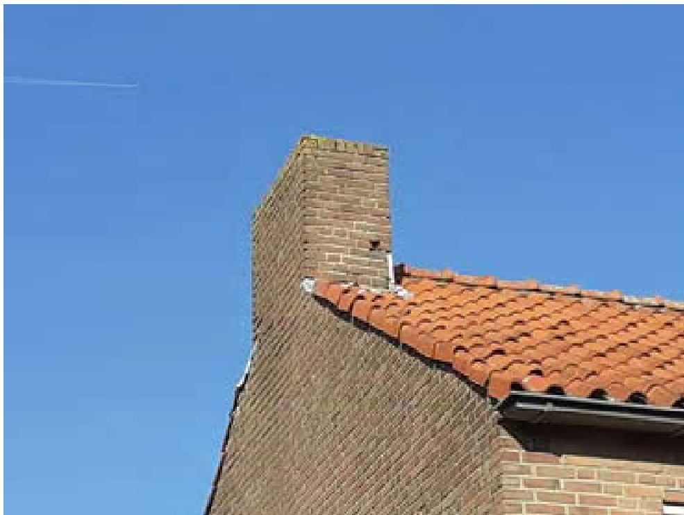
Figuur 3.1. Opening in de schoorsteen van woning aan de meeuwenstraat te Liendert vormt een nestplaats van gierzwaluw.
