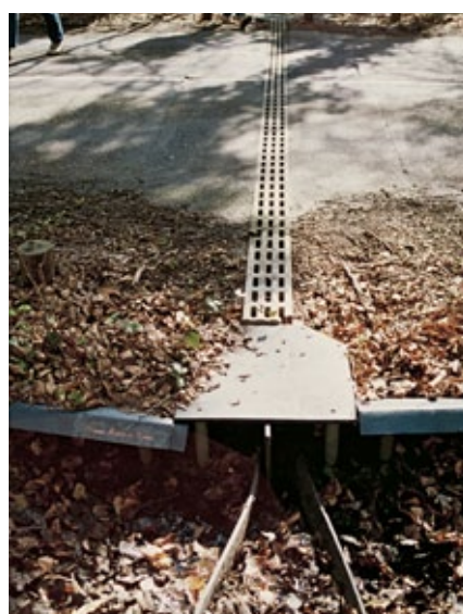
10.79 Voor amfibieën is extra geleiding naar de tunnelingang belangrijk (twee deels ingegraven kunststof platen).
