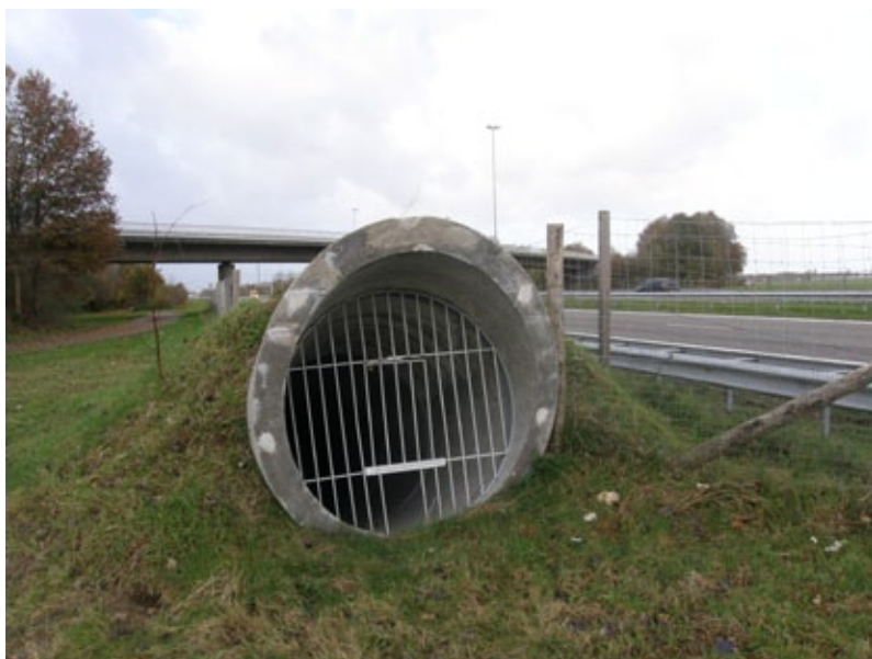
Fig. 10.75 Kindvriendelijke tunnel met rooster.
